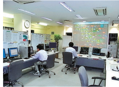
ガス供給監視体制
