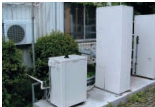
家庭用コージェネレーションシステム（エコウィル）の実証実験
