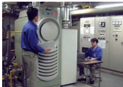
28kWマイクロタービン実証試験
