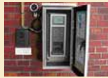
▲工場の入口は指紋照合式入 場管理システムを採用し、安全衛 生面での配慮をしています
