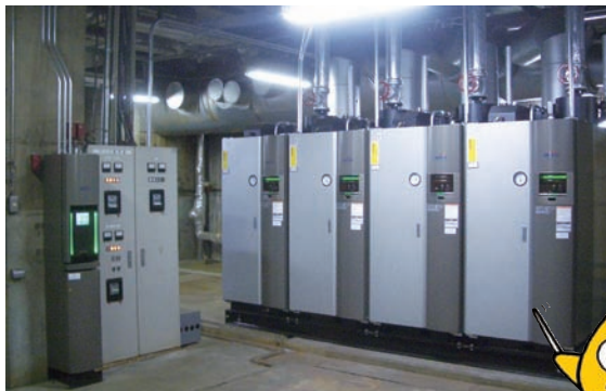
▲ガス式ボイラー
