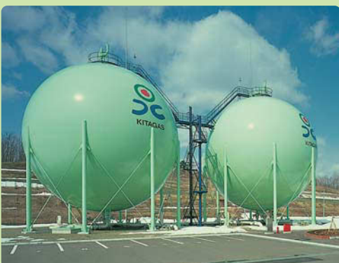
天然ガスの受入れ基地・中継地点 北広島供給所
