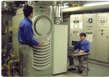
28kWマイクロタービン実証試験
