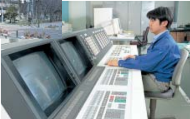
供給コントロールセンター
