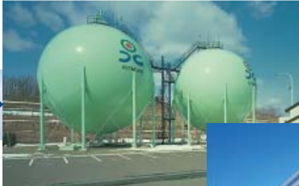
天然ガスの受入基地 北広島供給所
