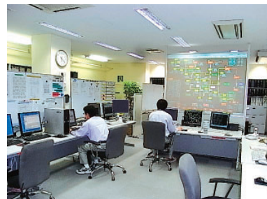
ガス供給監視体制
