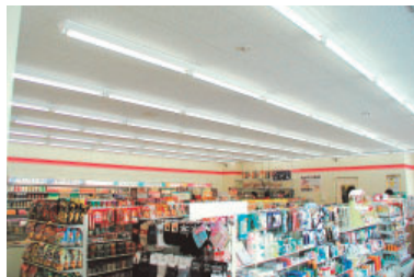
コンビニエンスストア照明設備
