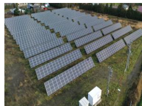
芦別太陽光発電所
