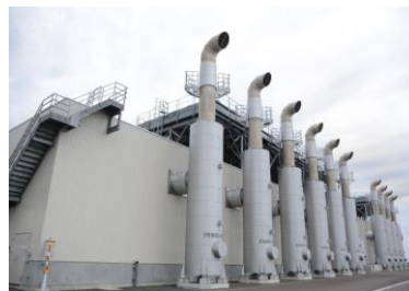
北ガス石狩発電所
