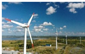
稚内風力発電所
