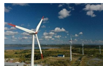
稚内風力発電所
