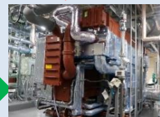
吸収式冷凍機 (排熱投入型) 1基
