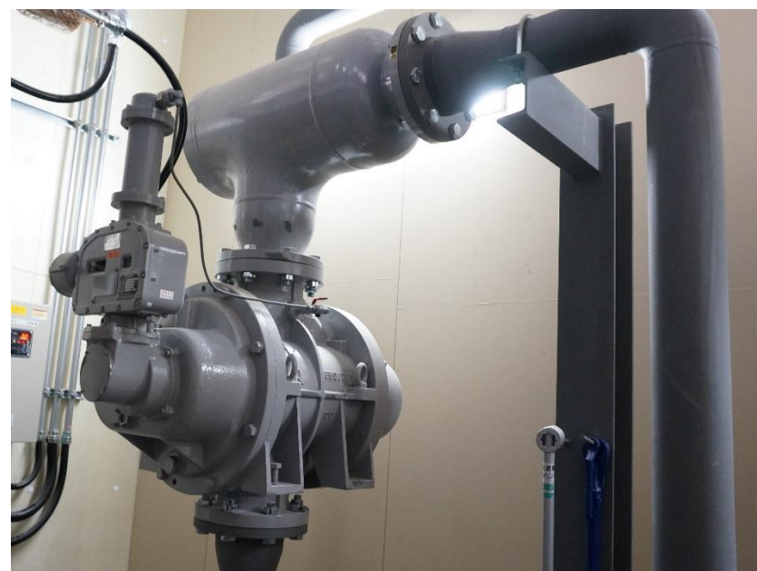
中圧ガス導管・メーター（46エネルギーセンター）
