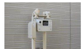
ガススマートメーター
