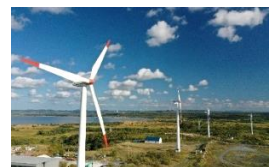
稚内風力発電所
