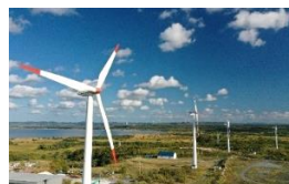
稚内風力発電所
