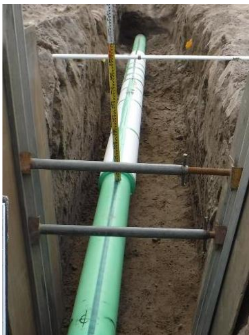
中圧ガス導管
