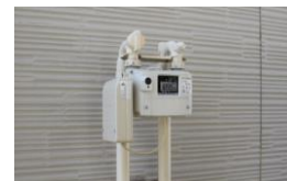
ガススマートメーター
