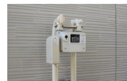
ガススマートメーター
