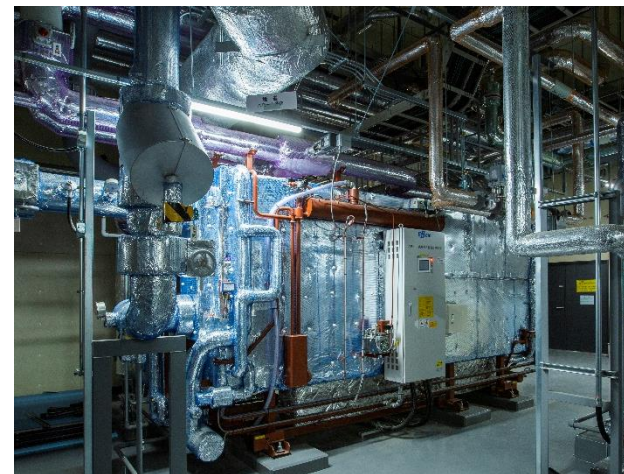
▲吸収式冷温水機
