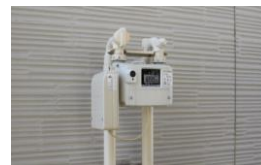
ガススマートメーター
