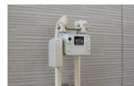
ガススマートメーター
