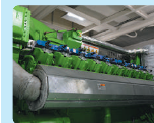
天然ガスコージェネレーション (発電容量 約2,500kW)
