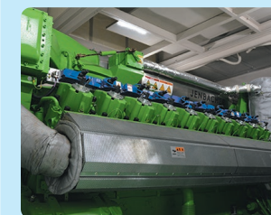
天然ガスコージェネレーション（発電容量 約2,500kW）
