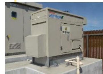
LPG非常用発電機
