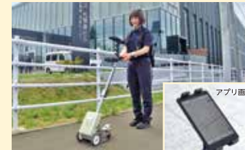
GNSSを利用したガス導管検査管理システム
