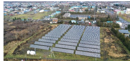
芦別太陽光発電所
