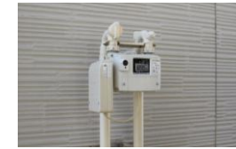
スマートメーター
