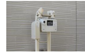
スマートメーター
