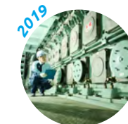
北ガス札幌発電所 運転開始
