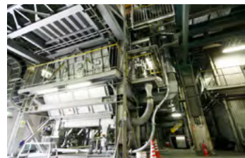
木質バイオマスボイラ
