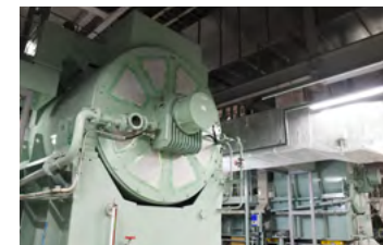
札幌発電所ガスエンジン
